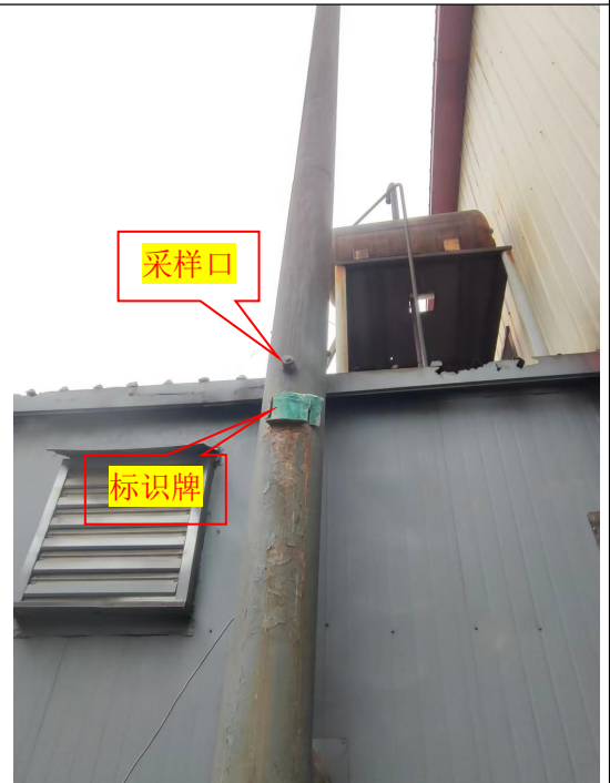
废气排放口 P2 (DA002) 规范化标识及采样口
