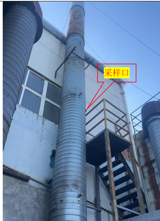
焊接废气、打磨废气、抛丸废气、喷粉废气排放口 P1 (DA001) 采样平台采样口
