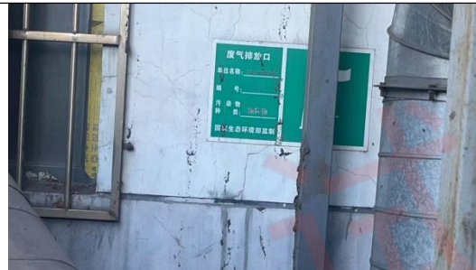
焊接废气、打磨废气、抛丸废气、喷粉废气排放口 P1 (DA001) 规范化标识
