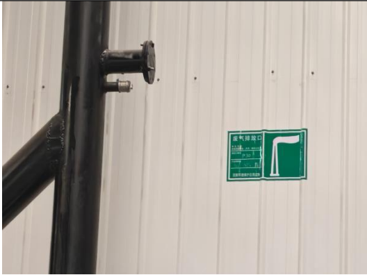
排气筒 P27 及采样口、标识牌
