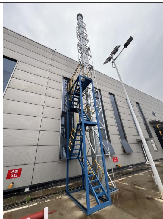
排气筒 P26 及采样平台
