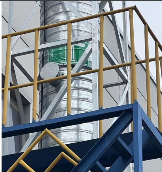
排气筒 P26 采样口、标识牌
