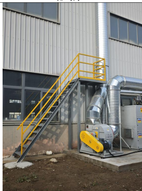
排气筒 P1 及采样平台
