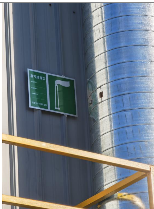
排气筒 P1 及采样口、标识牌
