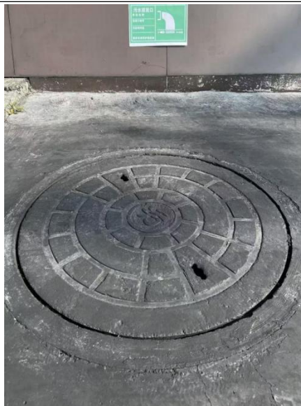
厂区污水总排口
