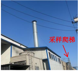
排气筒 P1 采样平台（位于风机房顶）
