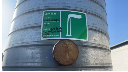
排气筒 P1 标识牌
