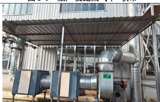
图 3-2 环保治理措施二级活性炭及排气筒标识牌
