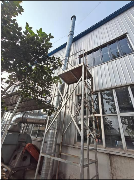
图 3-3 排气筒 P1 及采样平台
