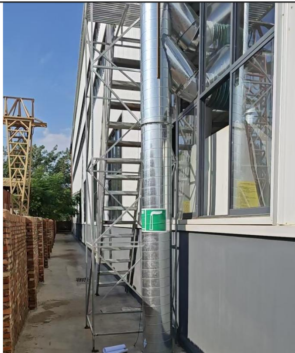
排气筒 P1 标识牌
