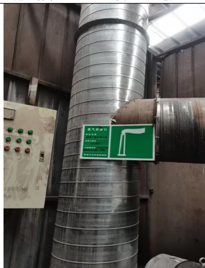
排气筒 DA003 (油性漆喷涂、固化烘干)
