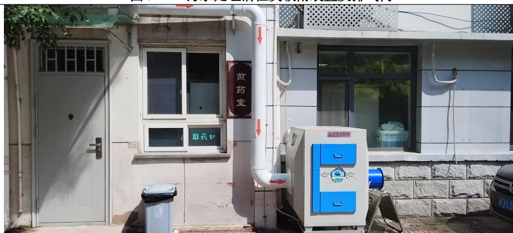
煎药废气活性炭吸附箱废气处置设备
