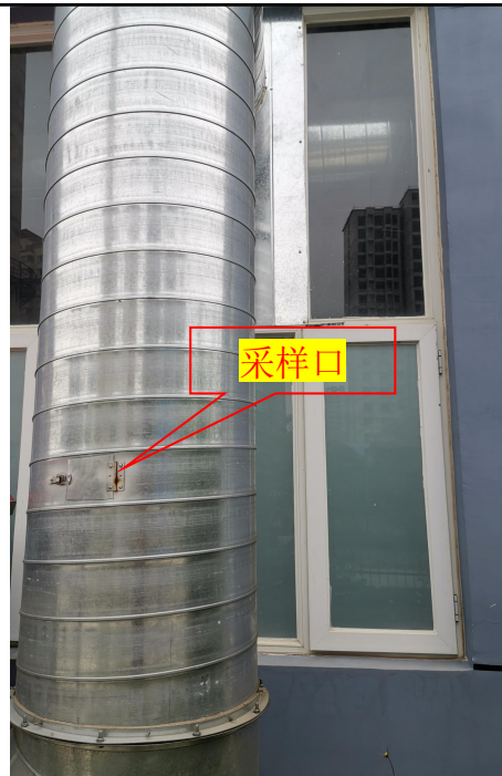
厂房三印刷废气排放筒 P1 采样口
