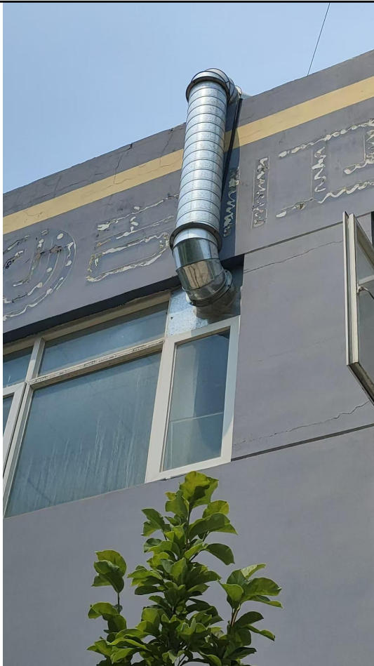
食堂油烟废气排放筒 P2 排放口规范化标识
