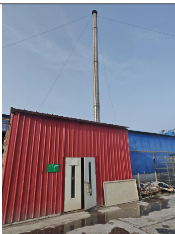
排气筒 P1 及标识牌
