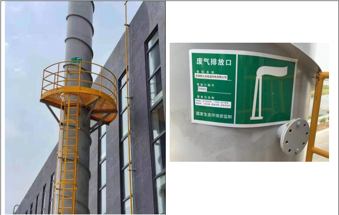
排气筒 DA001 及标识牌
