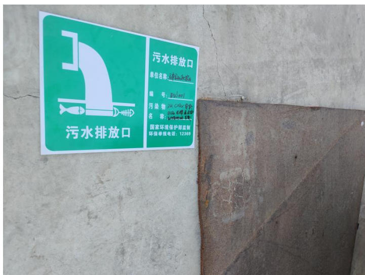
厂区污水总排口
