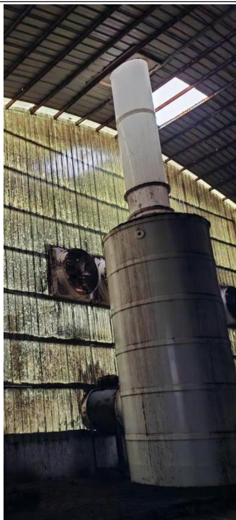
发酵废气排气筒DA001
