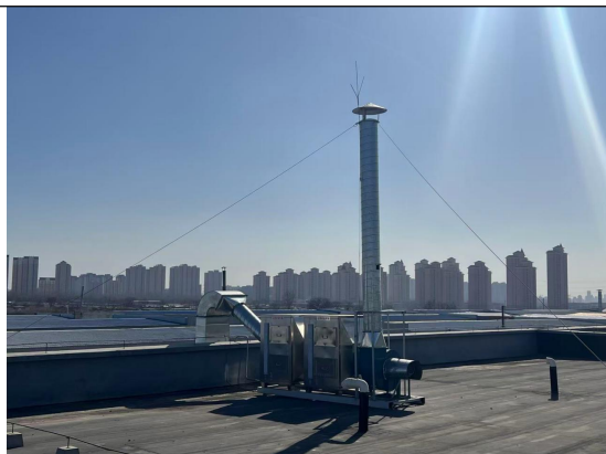
活性炭吸附+P1 排气筒
