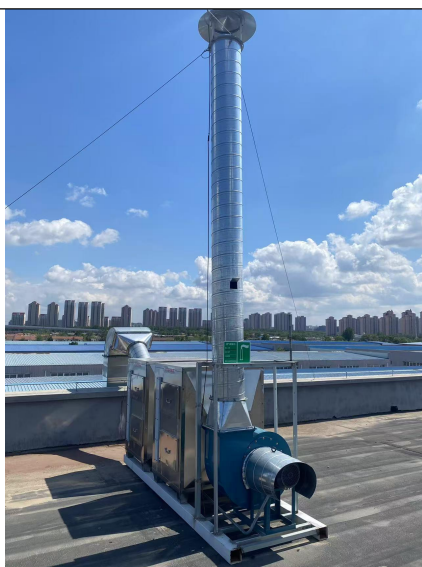
P1 排气筒+环保设备
