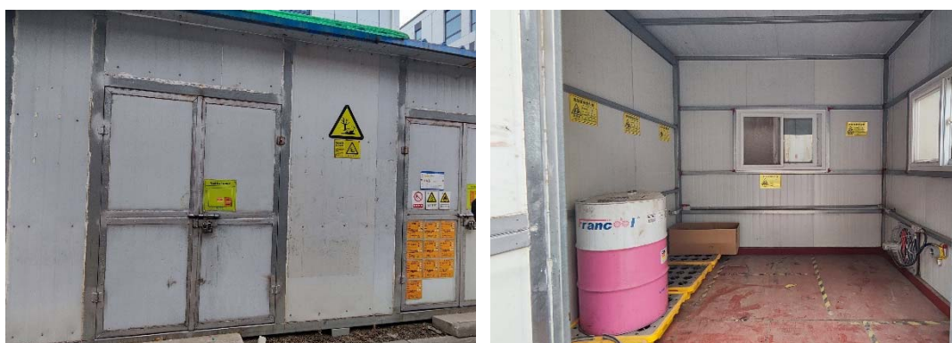
图 2.4-4 危险废物暂存间排污口规范化照片
